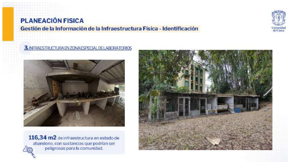
Figura 8. Zona de laboratorios abandonada.
